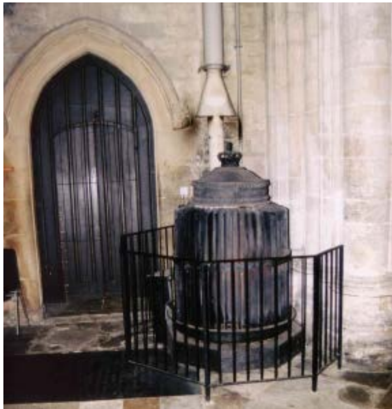
Eine Kirchenheizungsart, die in Deutschland nur selten zu finden sein dürfte: Mit Erdgas befeuerte Einzelöfen, im Bild in einer Kirche in England. Zum Schutz der Kirchenbesucher vor Verbrühungen wurde eine Absperrung errichtet.
